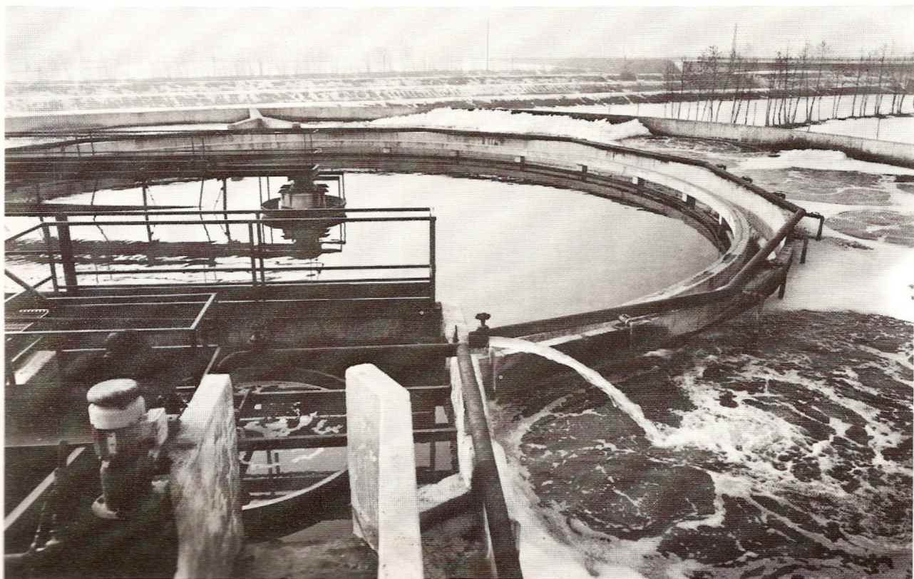
Il depuratore generale, costruito a sud del paese. Esso riceverà le acque nere del centro, della frazione Vighizzolo, della zona industriale di Ro e della Ditta Valentini, con cui l'Amministrazione ha stipulato un'apposita convenzione.
